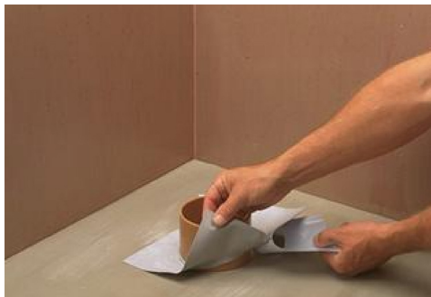
Tetning med Alfix Slukmansjett ved rørgjennomføring
