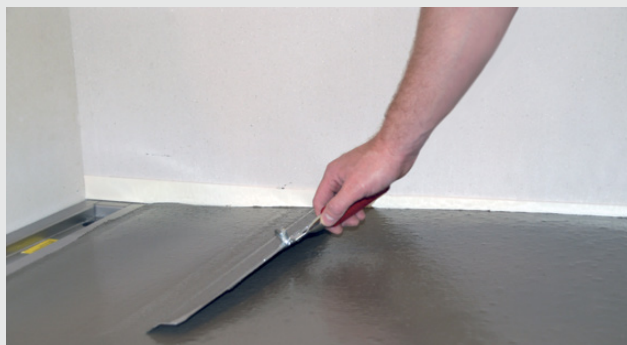
Nachylenie posadzki przy odpływach podłogowych blisko ścian
