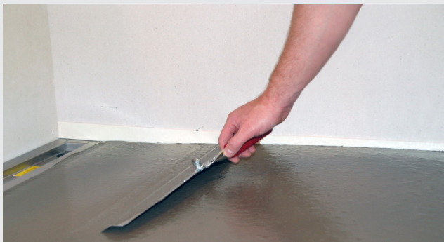
Golvlutning vid väggnära golvvbrunnar
