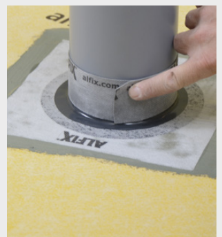
Förstärkning med Seal-Strip vid vattenbelastade rör
