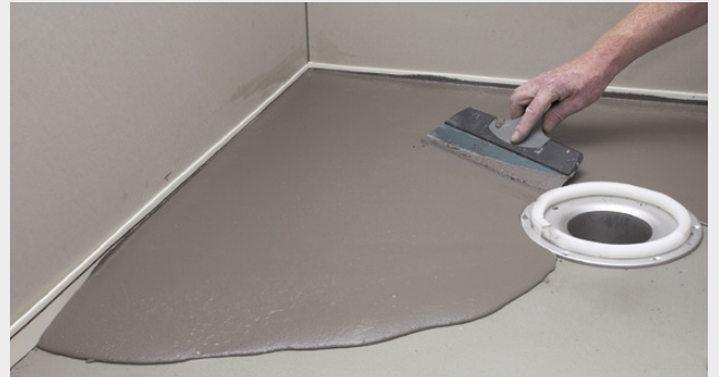
Golvlutning vid runda brunnar
